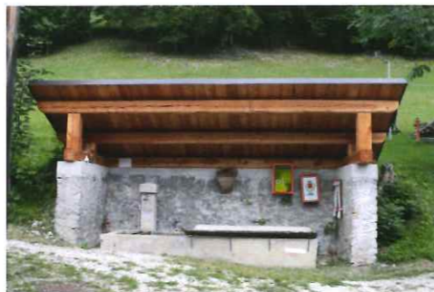
Pian - brenta kon kuèrt nuof Pian - Fontana col tetto rifatto. Un bell intervento di recupero da parte del comune fatto dopo Vaia
